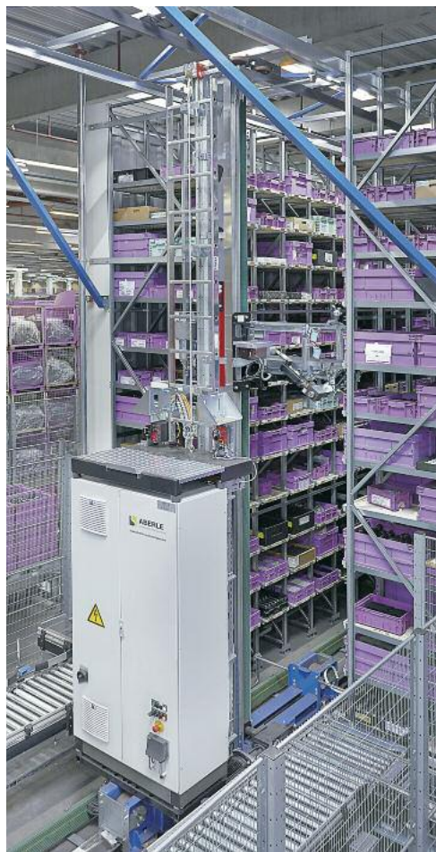
Bis zu 5 000 Tablare pro Tag können mit der Anlagentechnik von Aberle bei Schenker in Eching ein- und ausgelagert werden
