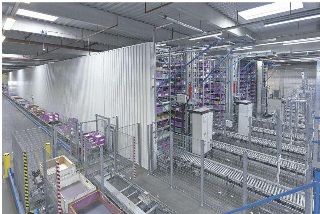
Die von Aberle eingesetzte SPS CPU 315F steuert die fünf RBGs exakt und energieeffizient. Das bei laufendem Betrieb um zwei Gassen erweiterte AKL bietet 27 000 Tablarstellplätze
